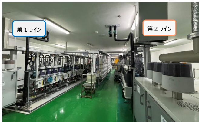
現像・エッチング・剥離ライン
