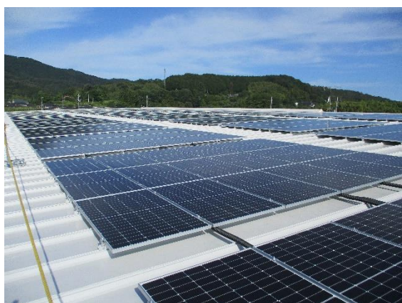
三和電子の工場屋根に設置した太陽光パネル
